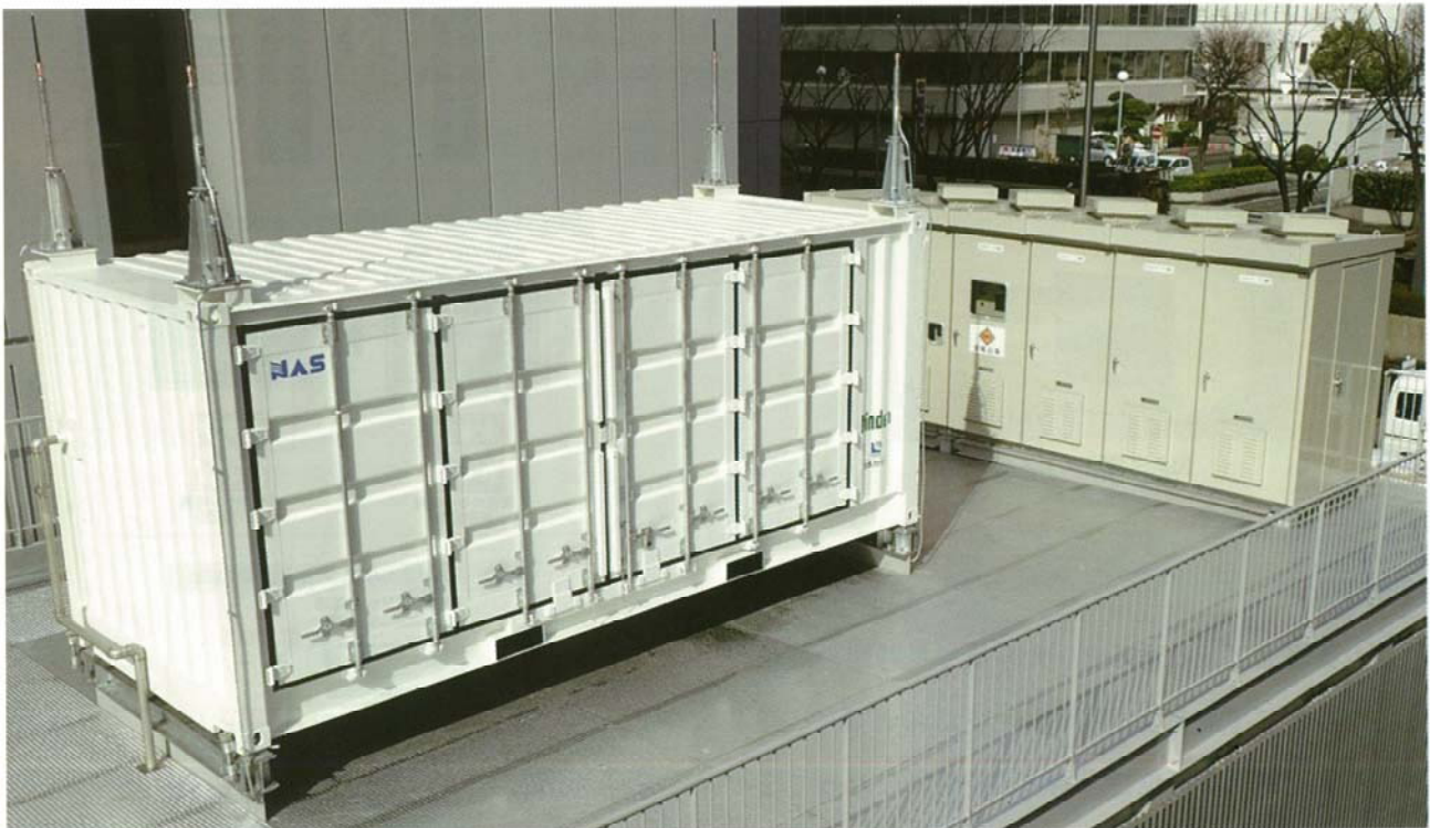
本店ビルに導入したNAS電池システム
