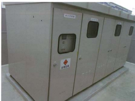
共同充電所電気室 1,050KVA
