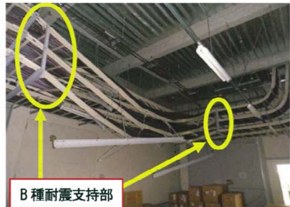
写真4 B種耐震支持部前後の自重支持材の落下
