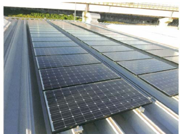
図5 折板屋根上の太陽電池（可視画像）
