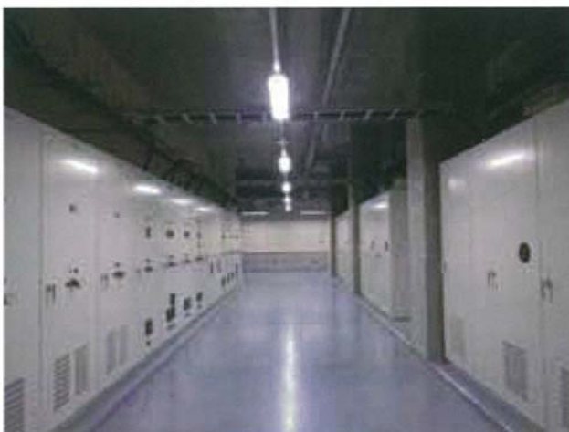
地下2階電気室内 受変電設備
