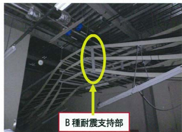
写真5 B種耐震支持部前後の自重支持材の落下
