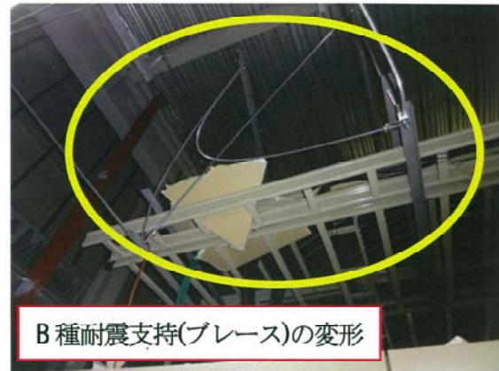
写真3 B種耐震支持の変形
