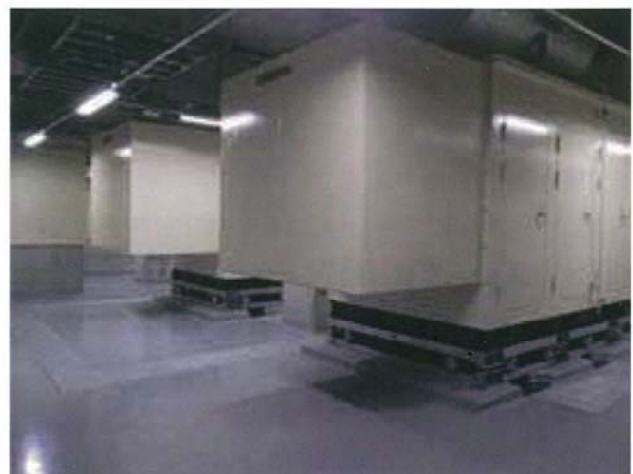
地下2階発電機室内 自家発電設備
