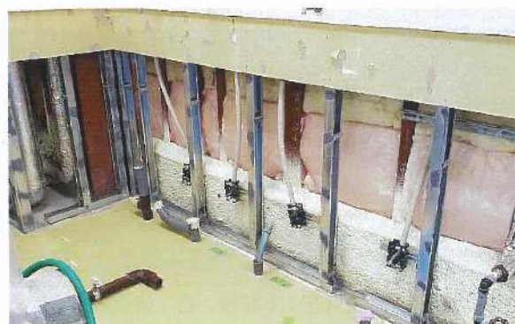
図3：現場内浸水状況
